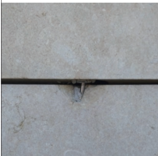
Figura 125. Rotura ocasionada en taladro rellenado con masilla rígida.
