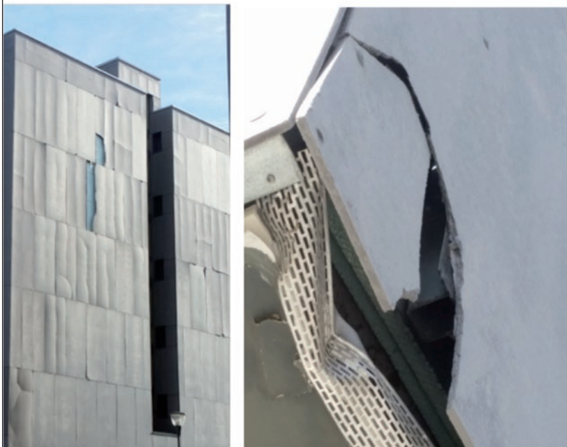
Figura 39. Ejemplo real de patología por uniones rígidas entre perfilería y revestimiento.
