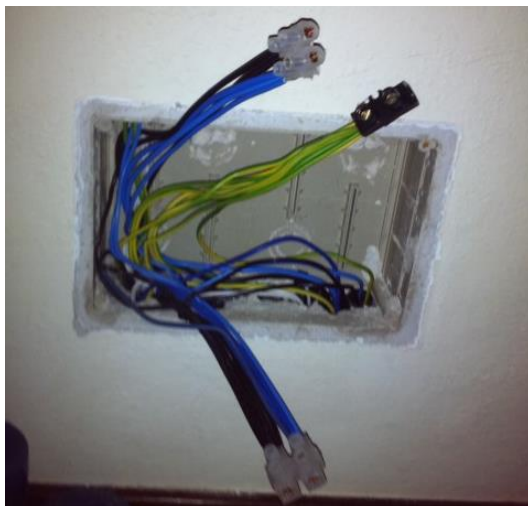
Figura 115. Cableado existente en el interior de una caja de registro
