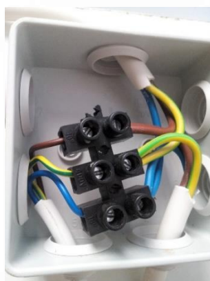
Figura 101. Conexión cable alimentación en caja de conexiones.
