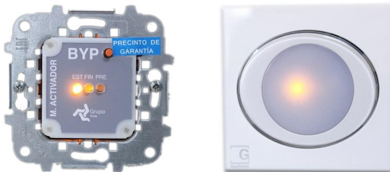
Figura 22. Activador (3) con LED EST en Amarillo Parpadeante. Comunicación no efectiva.
